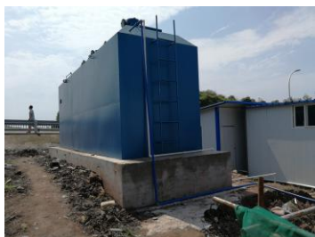
厂前区二级生化装置
