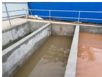
施工区内三级沉淀池
